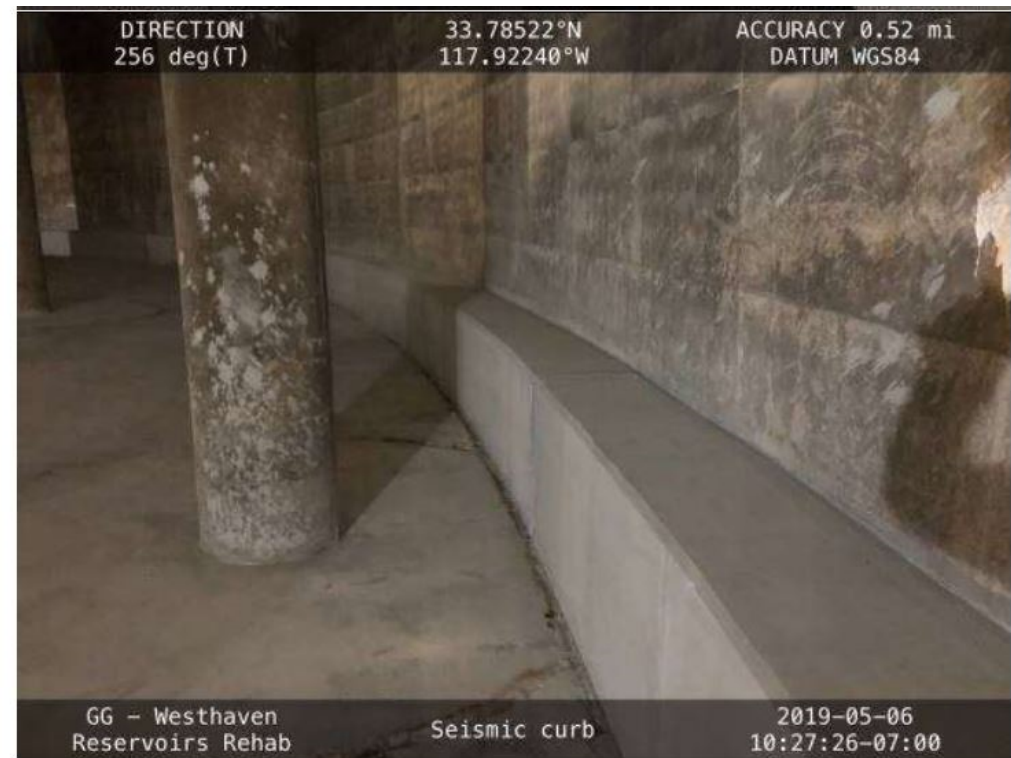
Thành chống Địa chấn
